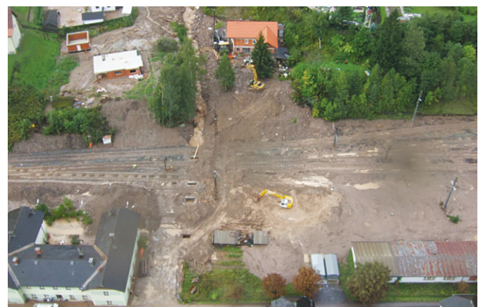
Fig. 1. Debris flow at Tullbach, Austria Bild 1. Murgang im Tullbach, Österreich
